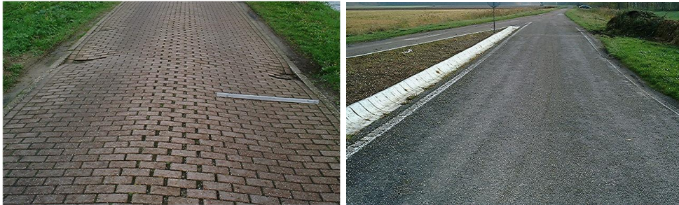
Figuur 2 Schades dwarsonvlakheid en rafeling
