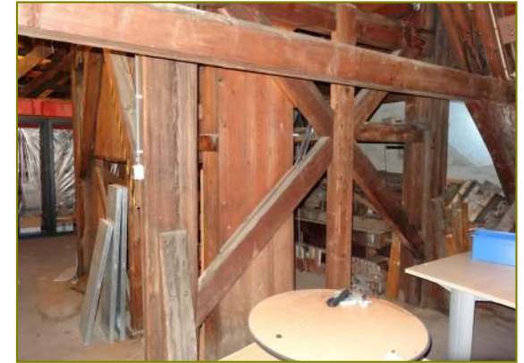
Constructie daktoren en gewichtkoker uurwerk
